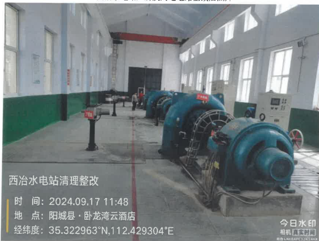
西冶水电站水轮发电机组照片
