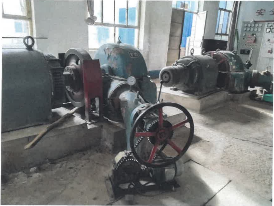
石峡水电站水轮机发电机及控制屏
