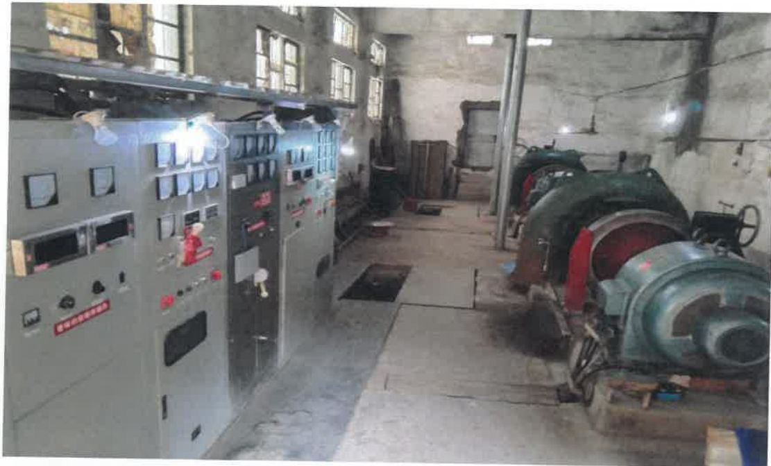
杜甲水电站水轮发电机及控制屏
